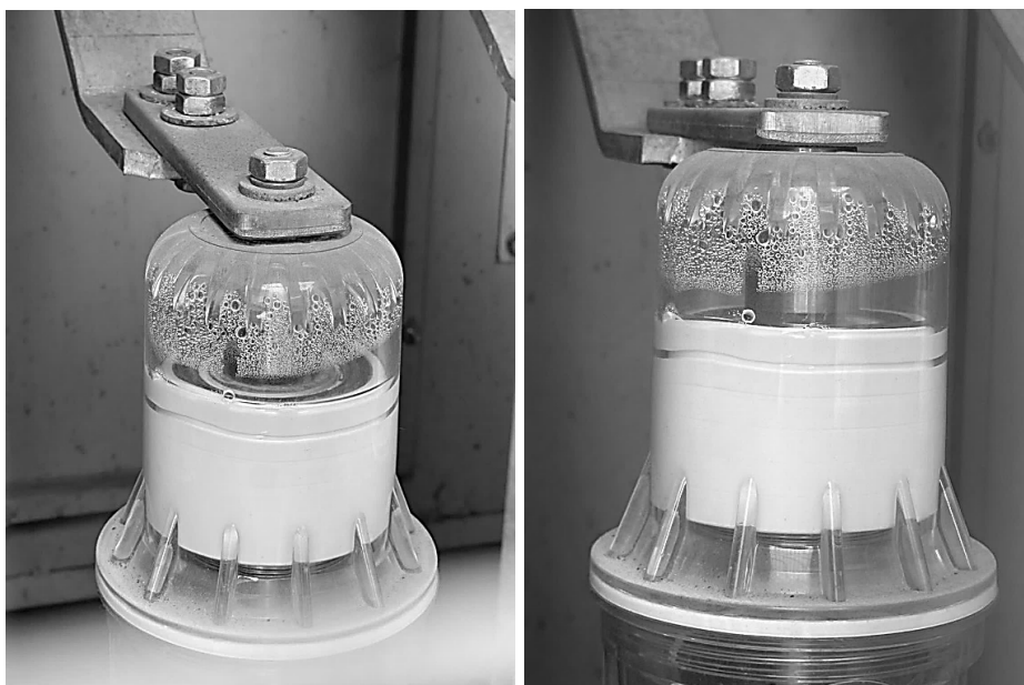
Рис. 2. Выпадение конденсата внутри корпуса фазы вакуумного выключателя типа ВВ/TEL-10-20/630 находящегося под напряжением на действующей подстанции в РУ-6 кВ (из архива авторов)
